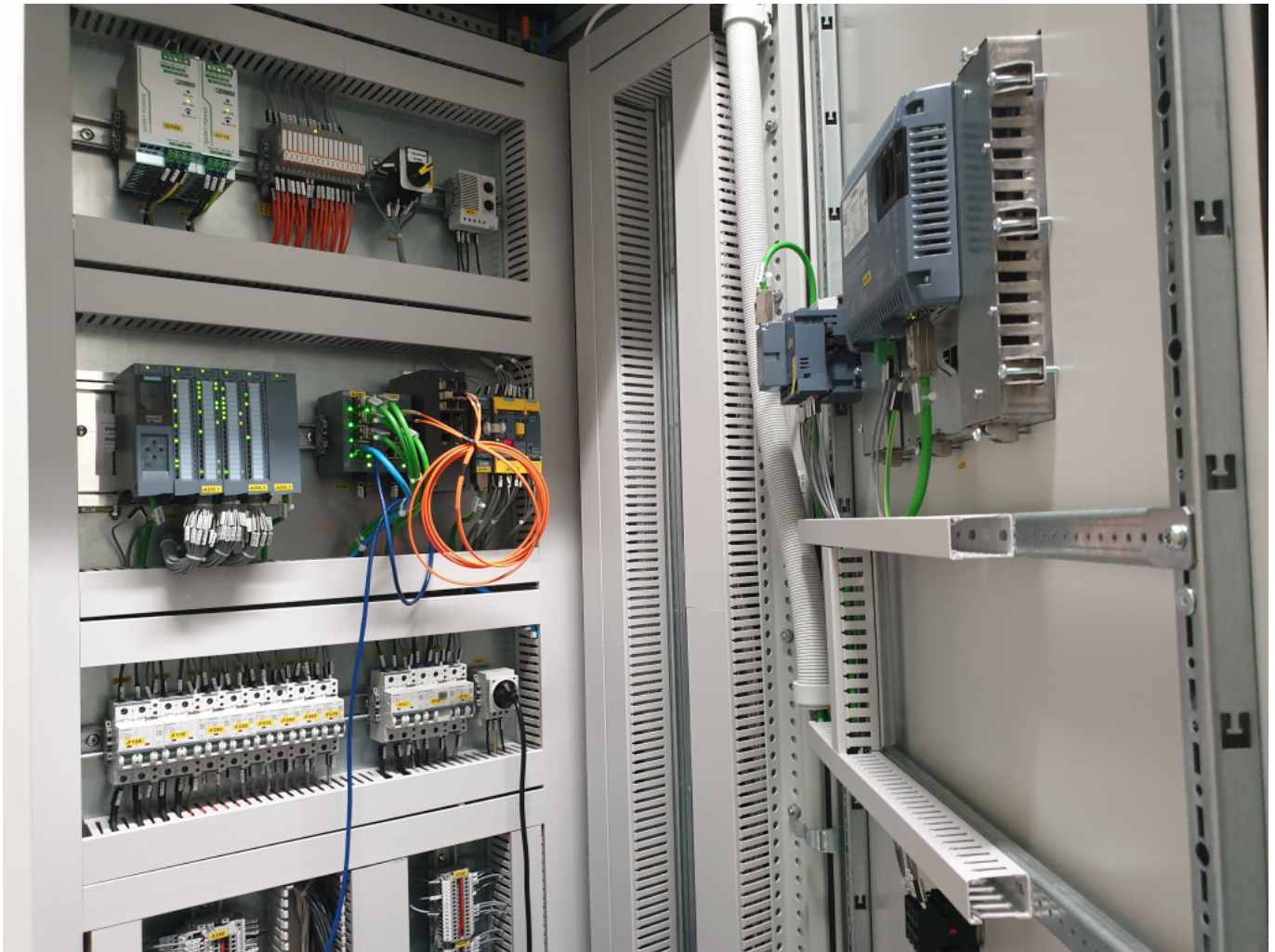
A parti oldal vezérlője (Simatic)
